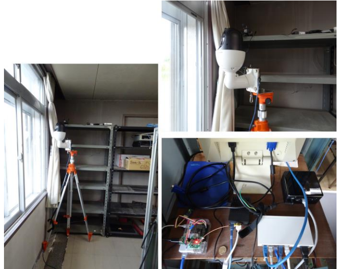
図1 鹿児島観測所設置システム外観
