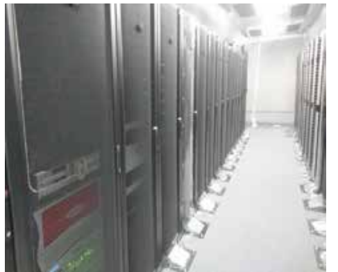
CIDASスーパーコンピューターシステム。 The CIDAS supercomputer system.
