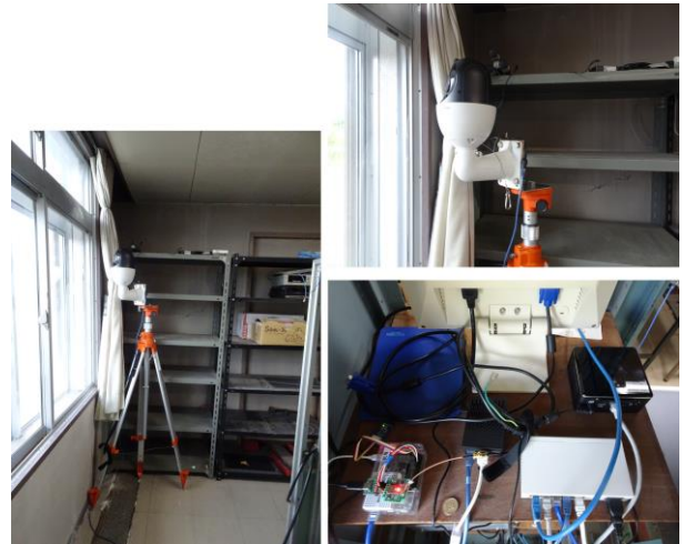
図1 鹿児島観測所設置システム外観
