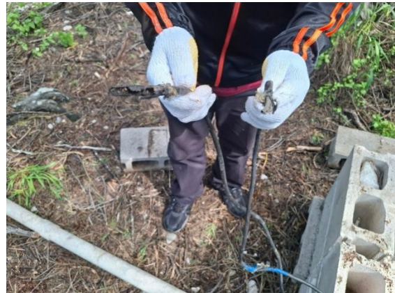
図 1 断線したメインケーブル
