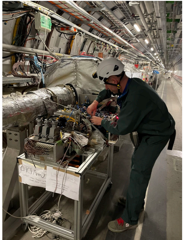
LHC トンネル内に検出器を運んでの最終動作テストの様子。手前にあるのが LHCf 実験の検出器で、奥に周長 27 km に及ぶ LHC 加速器トンネルが続いている。
