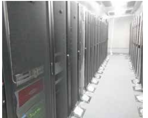
CIDASスーパーコンピュータシステム。 The CIDAS supercomputer system.
