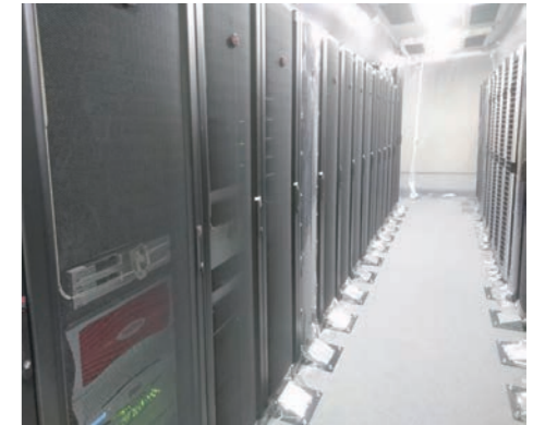
CIDAS スーパーコンピュータシステム。 The CIDAS supercomputer system.
