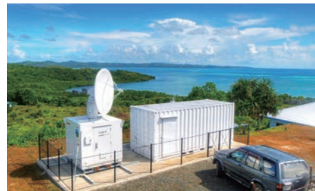
パラオ共和国に設置された偏波レーダ。 Multi-parameter radar installed in Palau.
